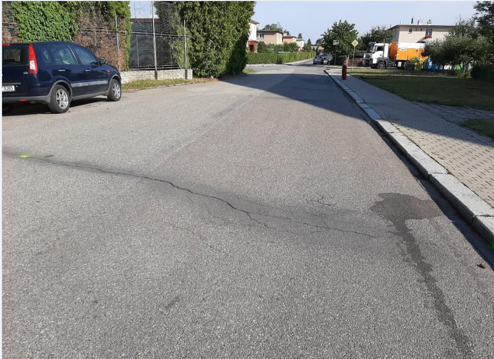
Původní stav vozovky: příčná trhlina (2023)
