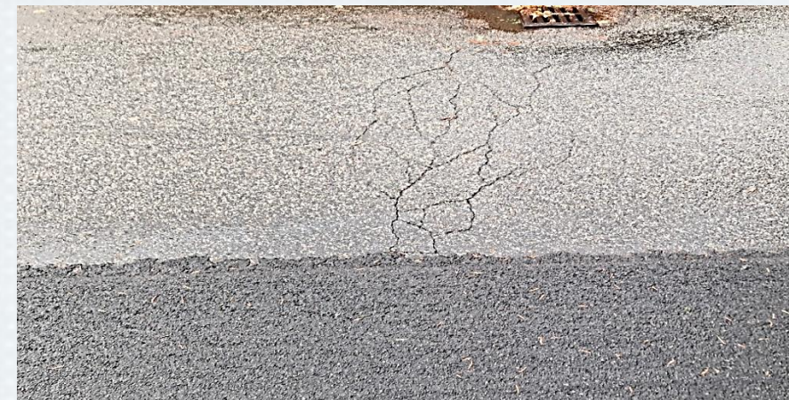
4 měsíce od realizace: zastavení šíření trhlin
