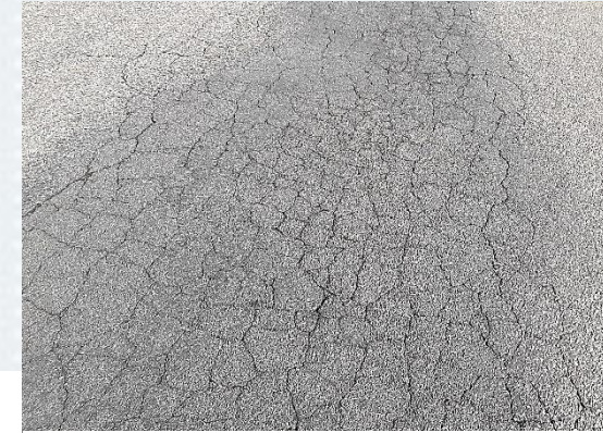
Detail na vozovku (2023)
